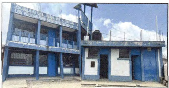
Foto 5: Pintura en mal estado
