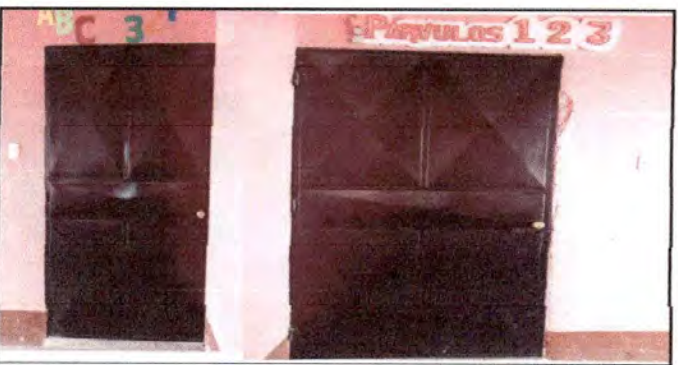
Foto 5: Puertas en mal Estado
