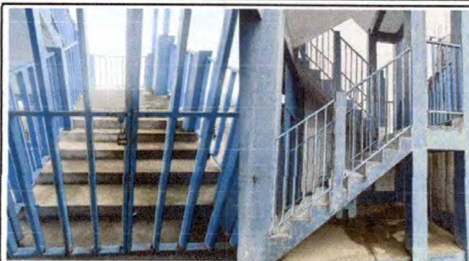
Foto 2: Barandas en mal estado
