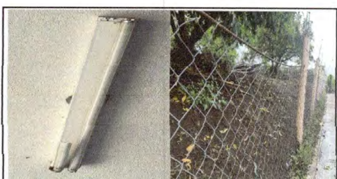
Foto 6: Lamparas y muro en mal estado
