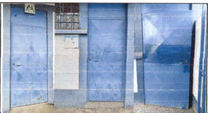
Foto 3: Puertas en mal Estado
