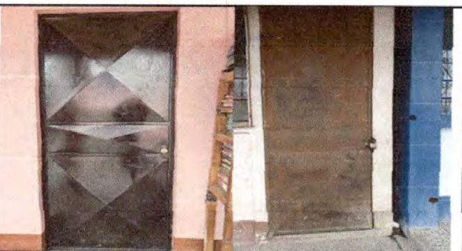
Foto 6: Puertas en mal Estado
