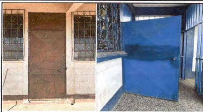
Foto 2: Puertas en mal estado de pintura
