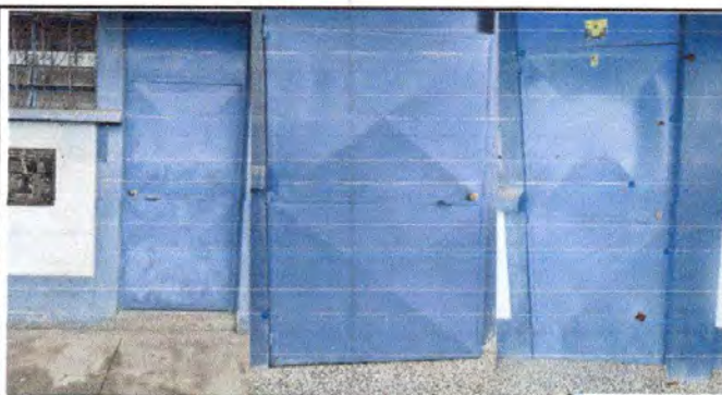
Foto 4: Puertas en mal Estado
