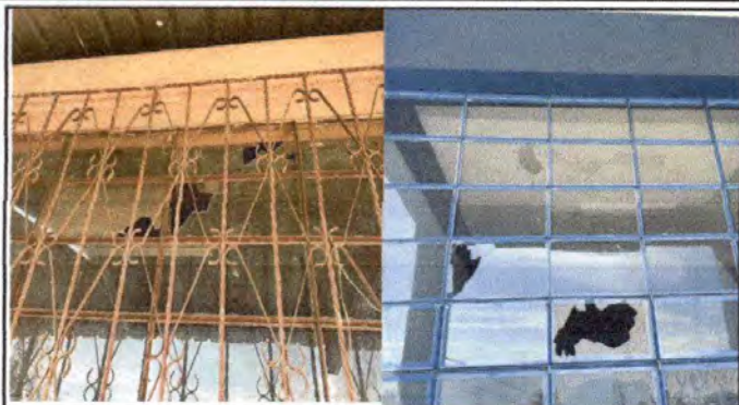
Foto1: Vidrios de ventanas quebrados
